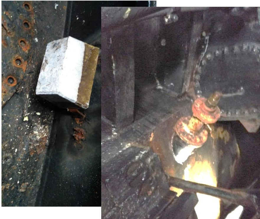
某潜艇压载舱腐蚀在线监检测
